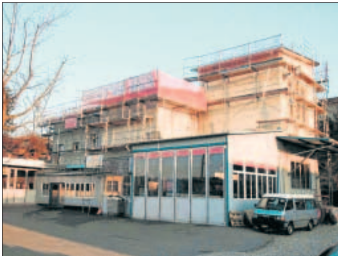
Schlechter Kompromiss: An der Lyssachstrasse wuchert vielfach verwinkeltes neues Volumen.
